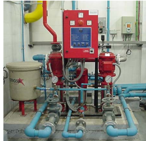
Fig.2 Grupo de presión contra incendios
