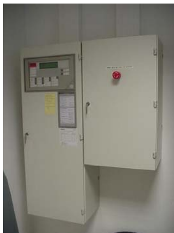
Central de Alarma
