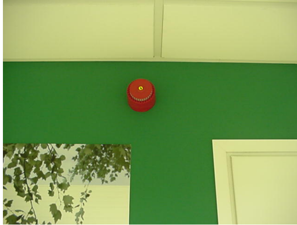
Sistema de alarma
