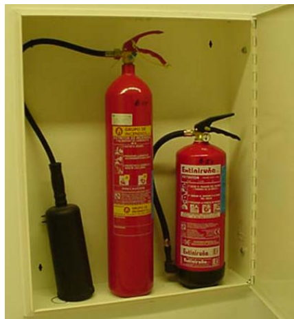
Fig.1 Extintores portátiles de Polvo ABC y CO 2
